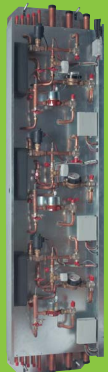
Caja completa con 3 Subcentrales
